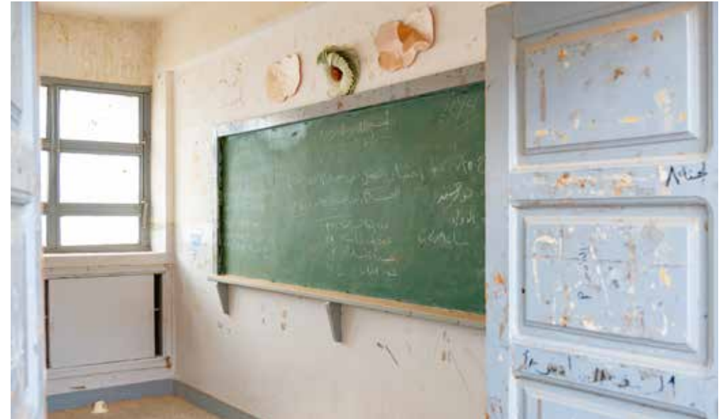
Preservation of Madrasat Addeera's original elements, such as this classroom, is key to the restoration project يُعدّ الحفاظ على العناصر الأساسية في مدرسة الديرة، مثل هذا الفصل الدراسي، جانباً أساسياً من مشروع الترميم
